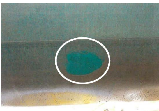
写真4 土嚢が接していた部分
