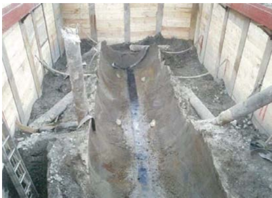
写真 2 倒壊した支柱
